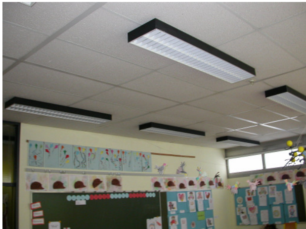
Bild 1: Typische Beleuchtungsanordnung Klasse alt mit über 25 W/m 2
